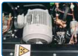
Silnik elektryczny 400 V / 5,5 kW
